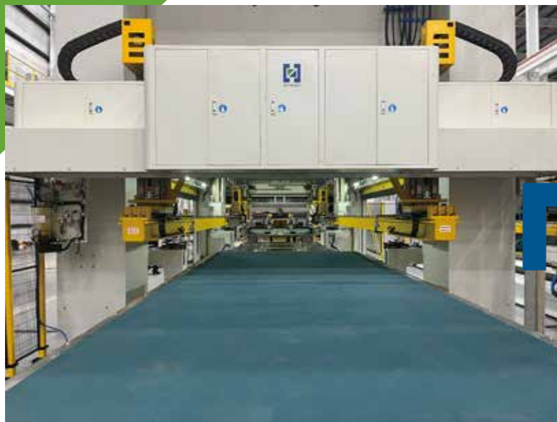
产品 现场应用实景图 On-site Application Photo
